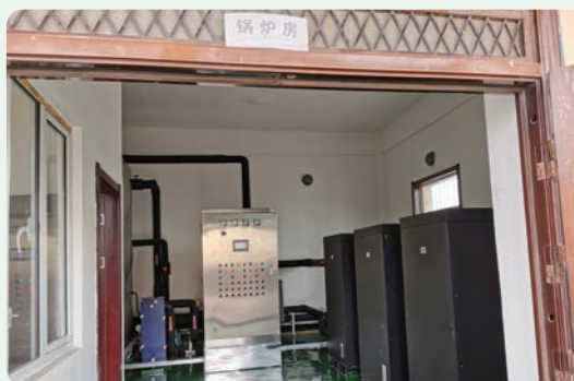
改造后的锅炉房
