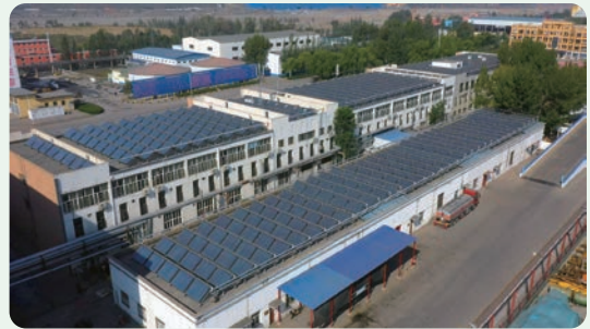
石圪台煤矿太阳能设备
