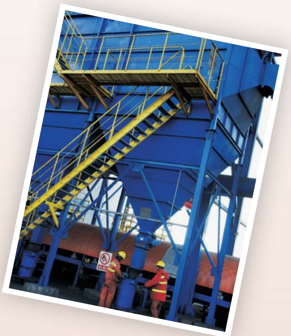
港口装船 静电除尘系统
