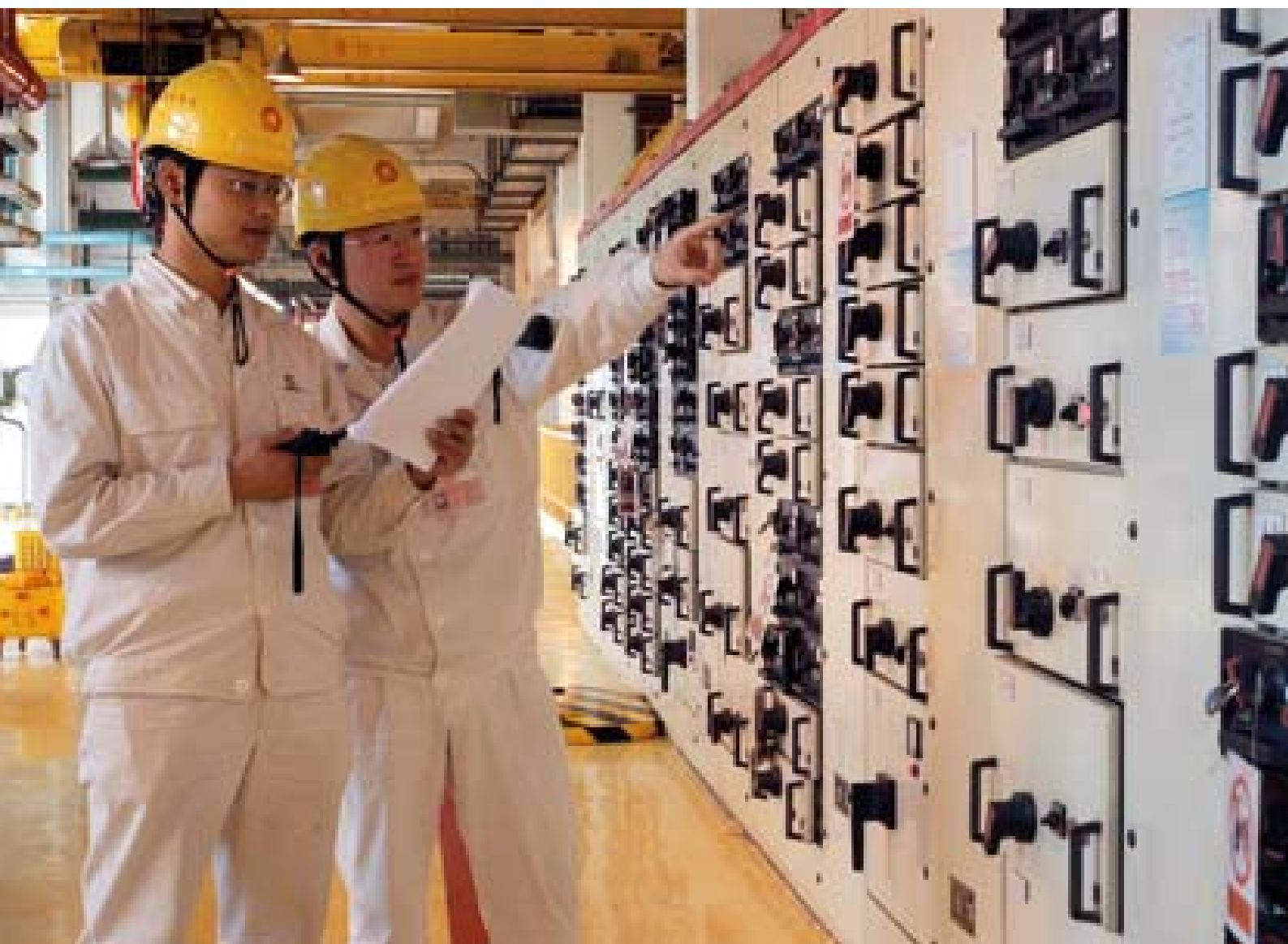
电厂设备监控检查
