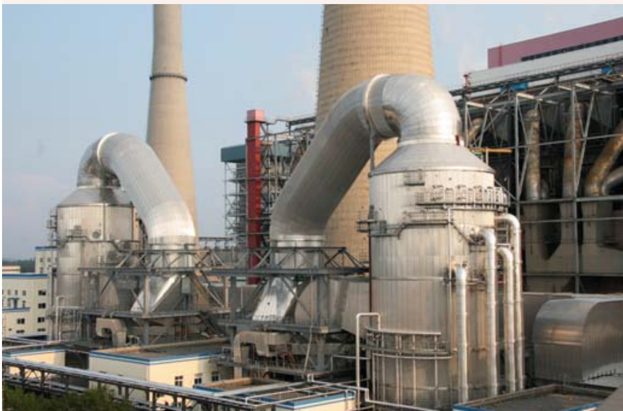
盘山电力脱硫工程全景
